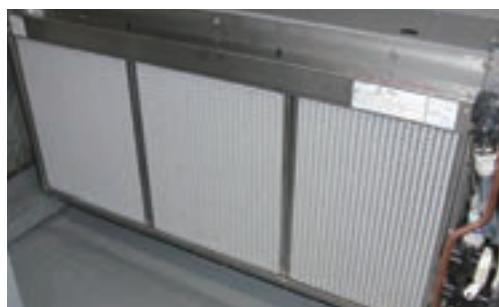
■ 加湿器ろ材交換
